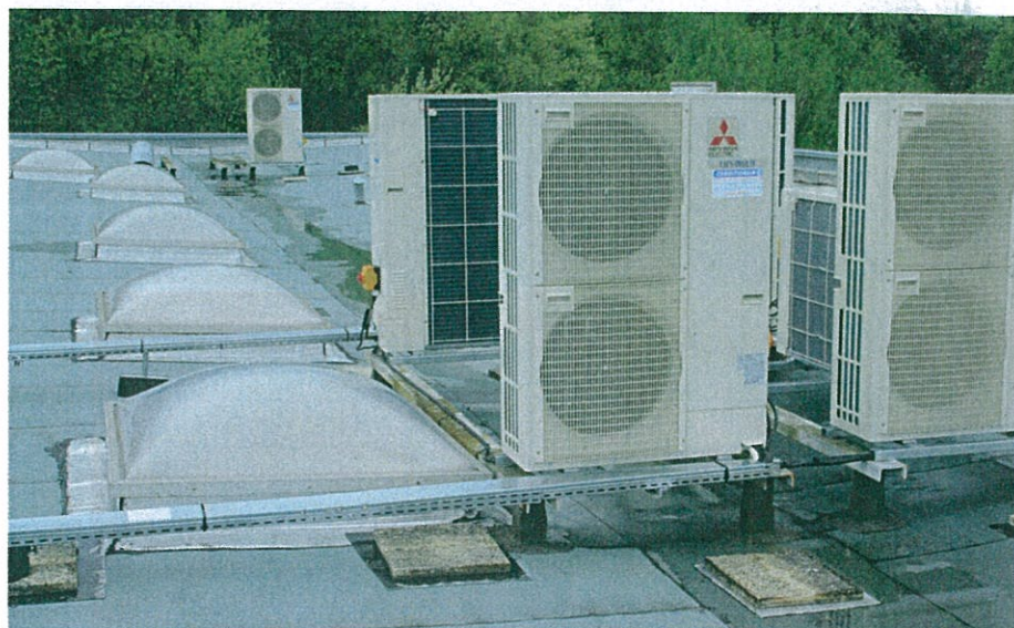
1. 5 groupes mini DRV permettent de gérer les bureaux donnant sur les 4 façades et la zone centrale du bâtiment en toute indépendance. Le poids est également mieux réparti sur la toiture.
